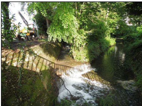
Avant travaux Chute liée à la présence de tuf
