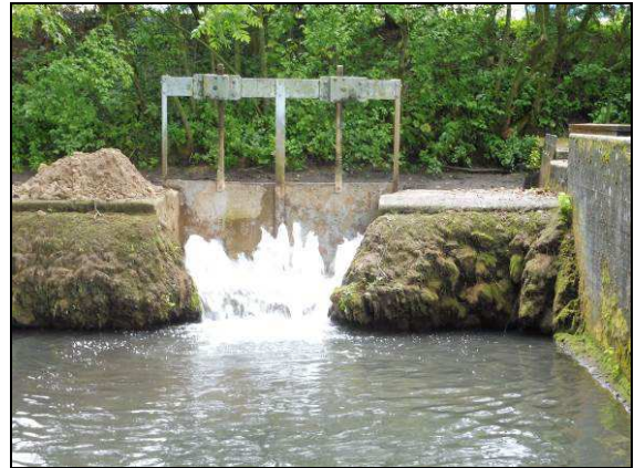
Vannes fermées avec un débit biologique assuré
